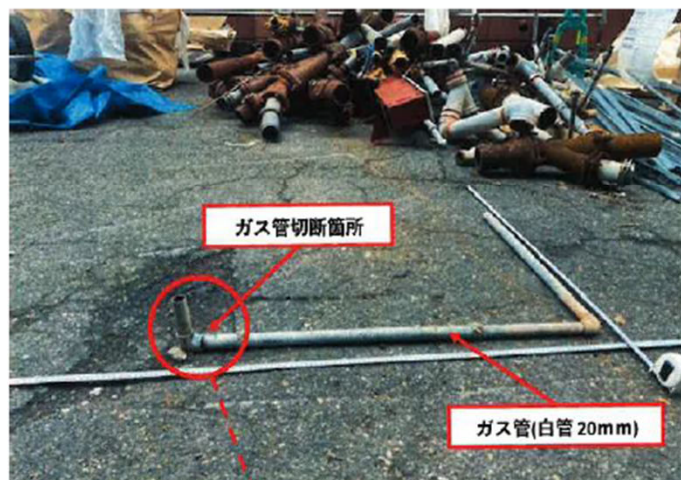
切断されたとされるガス管
