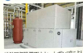
12 排熱回収設備
