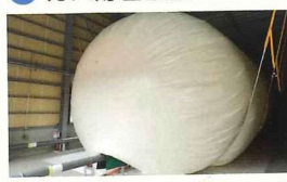
10 ガス貯留設備
