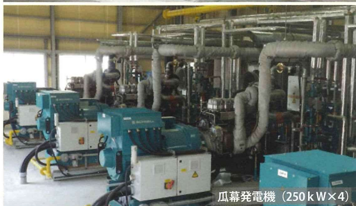
中鹿追発電機（190kW×1 100kW×1）
