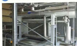
8 ガス除湿設備
