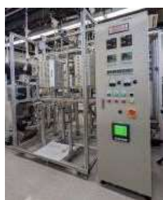
稼働中のGreen LPG 二段反応装置
